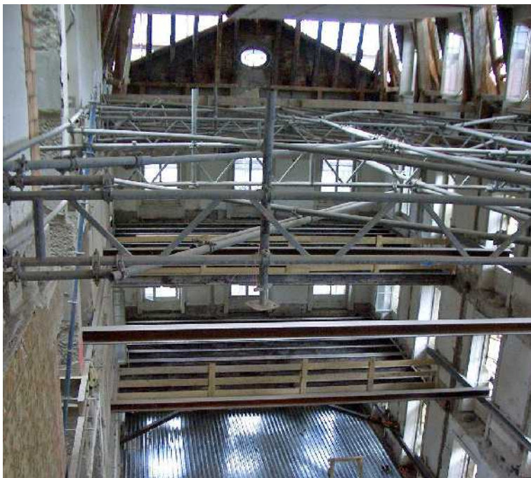
جایگزینی کف‌های بتن مسلح با کف‌های تیر چوبی در باله شرقی ساختمان.
